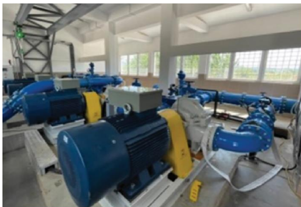
Пумпна станица Удово, подружница Јужен Вардар Гевгелија
